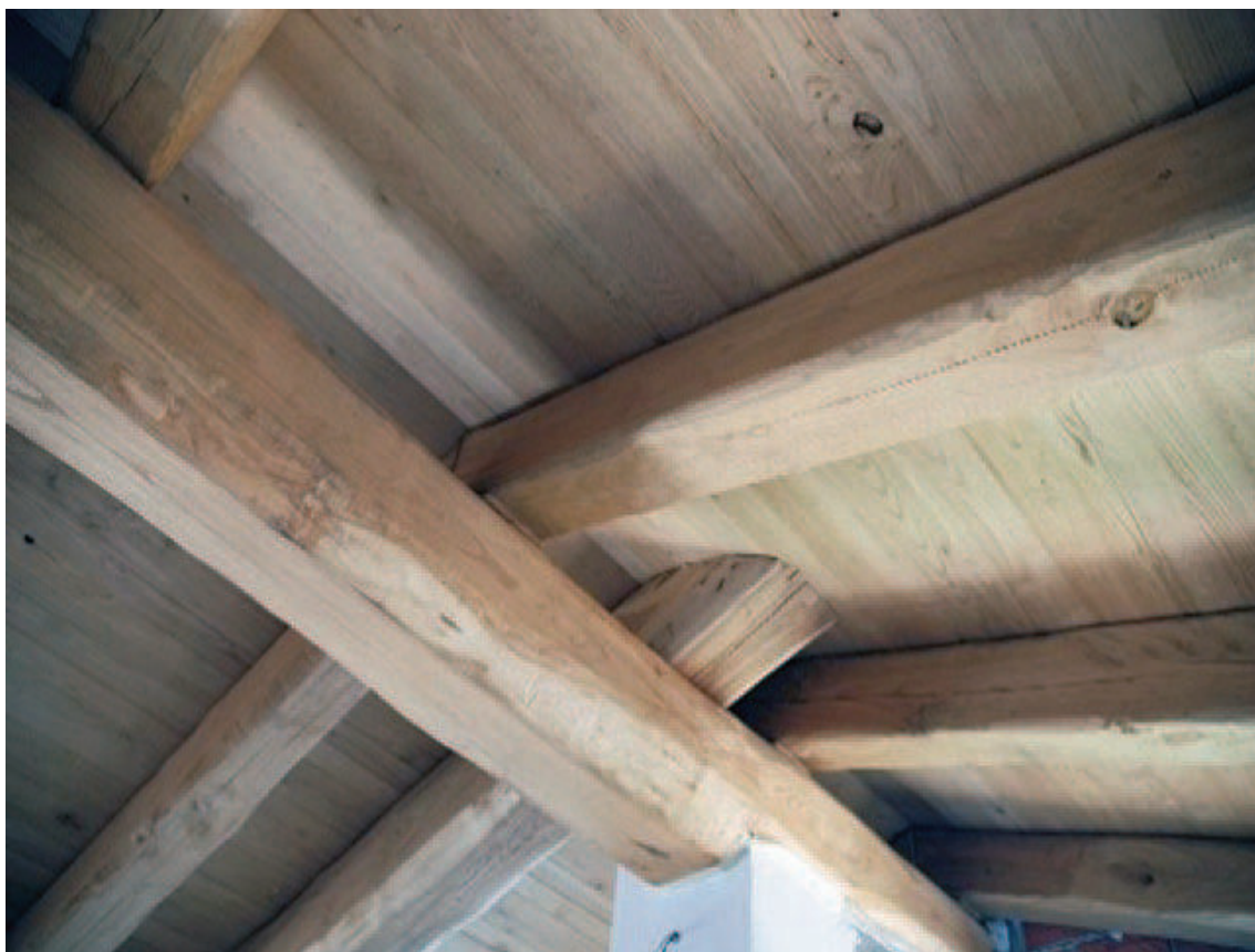
Fig. 1 - Esempio di travature (Uso Fiume) in legno di castagno, particolarmente apprezzate nelle opere di carpenteria tradizionale
